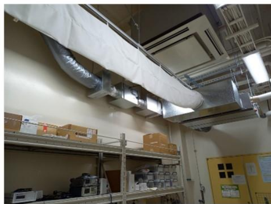
武田研の空調設備
