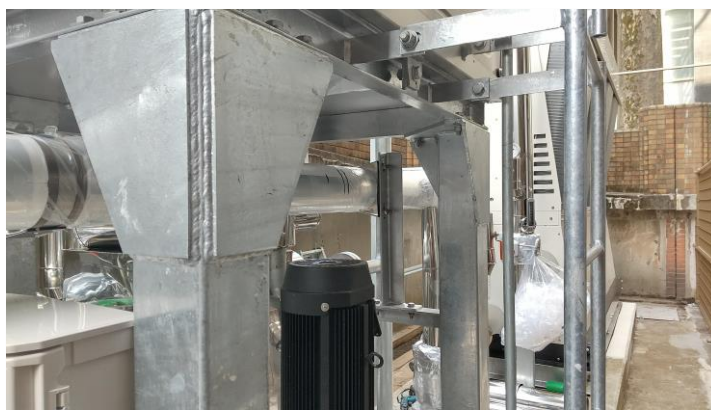
工 6 号館の冷却装置
